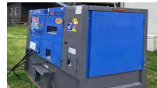
（非常用自家発電設備）
