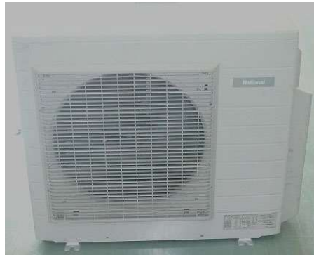
エアコン（室外機）（管理番号：A202200767）
